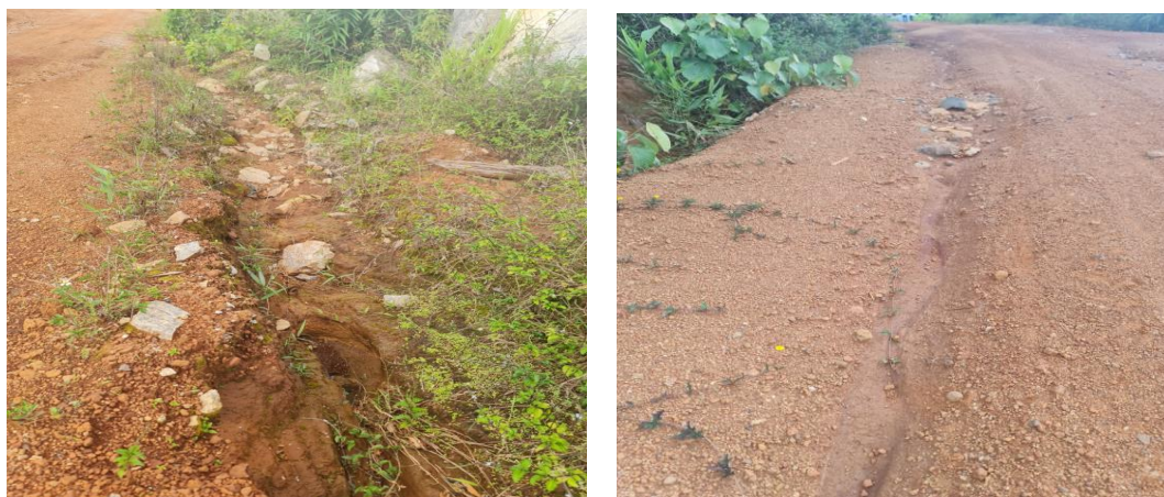
Hình 2: Rãnh dọc ngăn nước mưa vào moong và đường giao thông
